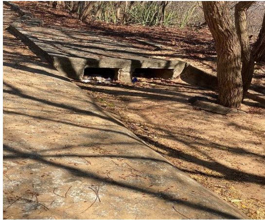
Imagem 3: Resíduos sólidos em águas pluviais.
