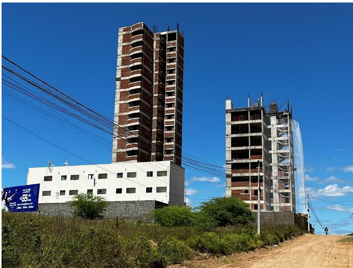
Figura 5: Edifício de grande porte erguido sem prescrições urbanísticas
