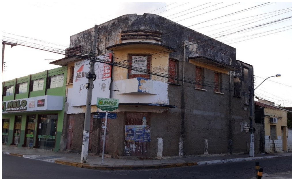
Figura 6. Prédio do antigo Edifício OK, em estado de deterioração.
