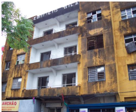
Figura 8- Edifício Bila. Fonte: Projeto ReHabitatar / Secretaria Municipal de Meio Ambiente e Urbanismo. Natal: SEMURB, 2007.
