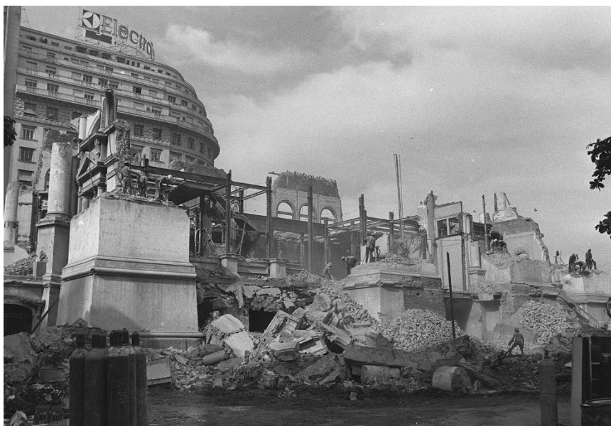
Fig.12: Palácio na fase final da demolição (Arquivo Público do Rio de Janeiro)
