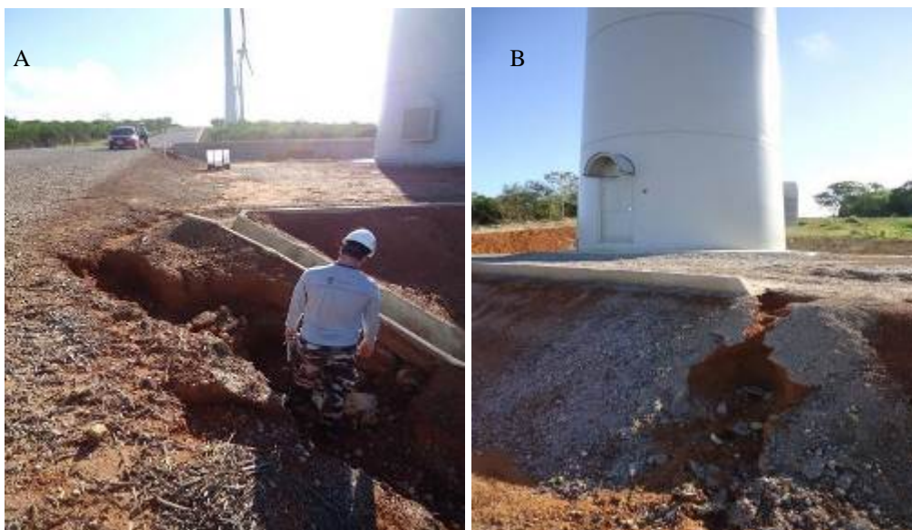
Figura 02 - Principais processos erosivos ocorrentes em parques eólicos na região Agreste do RN, causado por forte escoamento laminar, acentuados pela variação topográfica (A) e pela diferença de gradiente no talude (B). Fonte. O autor.
