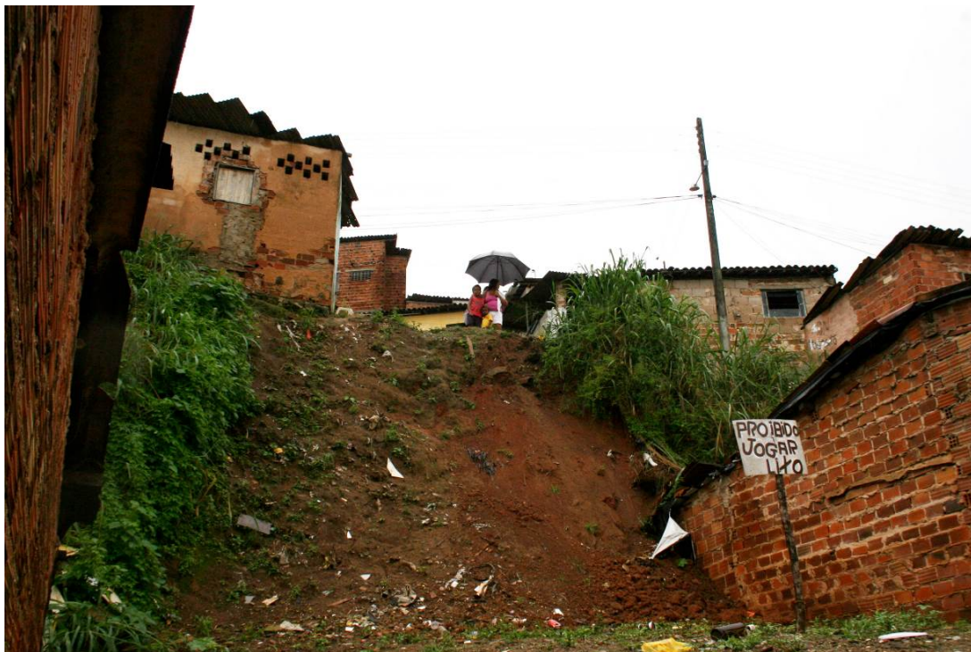
Figura 2: Localização do Talude no bairro do Mutange, em Maceió-AL. Fonte: COMDEC (2013).
