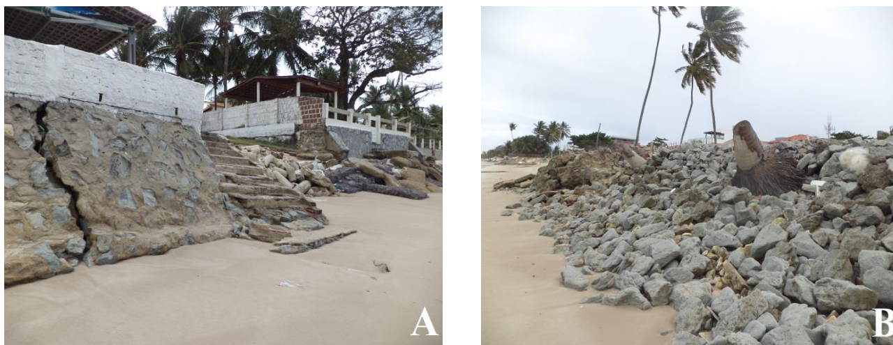
Figura 03: A – Muro de estabelecimento comercial rachado e obras de contenção ao fundo (sacos de areia, blocos de concreto); B – Rochas jogadas na praia para diminuir a energia das ondas. Fonte: Autor, Julho de 2016.
