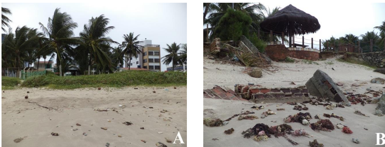
Figura 05: A – A linha de vegetação e ao fundo as residências sem avanço (Sem erosão); B – Estruturas de contenção e parte de um terreno destruído. Fonte: Autor, Julho de 2016.
