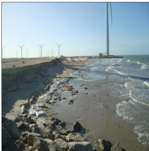
Figura 8. Destruição das vias de acesso e tentativa de enrocamento. Fonte: Autora (2011).
