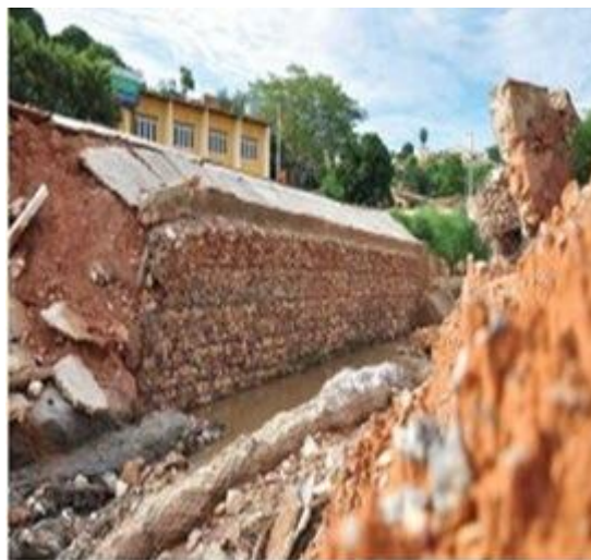
Figura 4. Obra de reparo emergencial desfeita em fevereiro de 2012. Fonte: Google imagens
