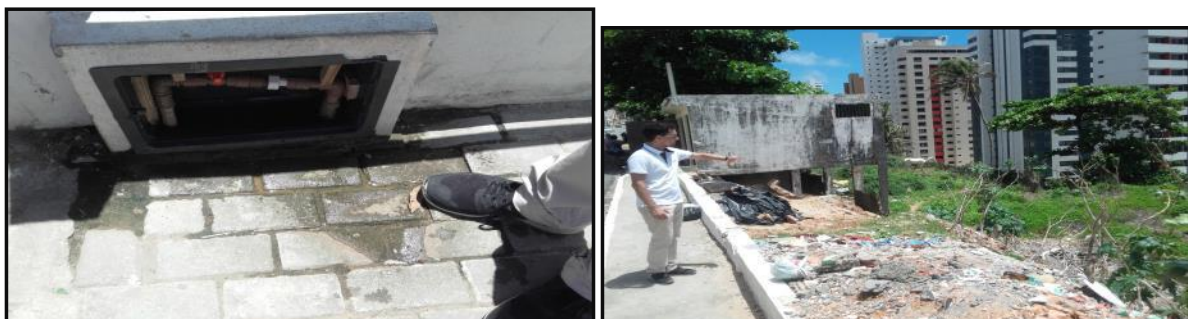
Figura 7: Vazamento de água. Nota-se que a calçada está cedendo devido à percolação da água em terreno arenoso (esquerda); Lixo e entulho depositado em encostas próximo à escadaria (direita).
