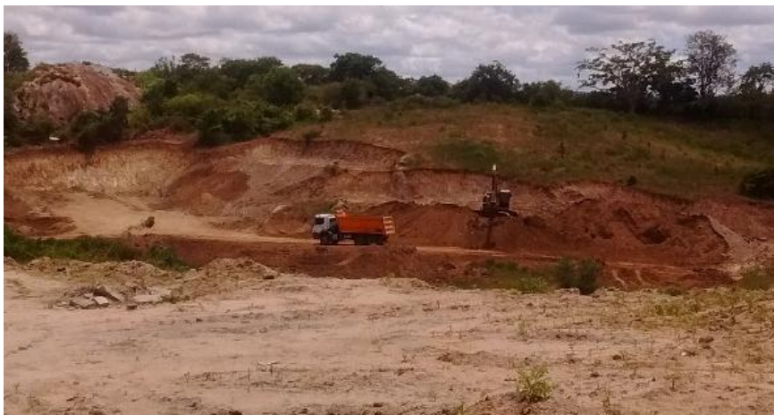
Figura 8 - Fotografia tomada de dentro da área da UC, com destaque para a degradação provocada pela extração de saibro. Fonte: Registro de campo, por Alexandro S. Souza.
