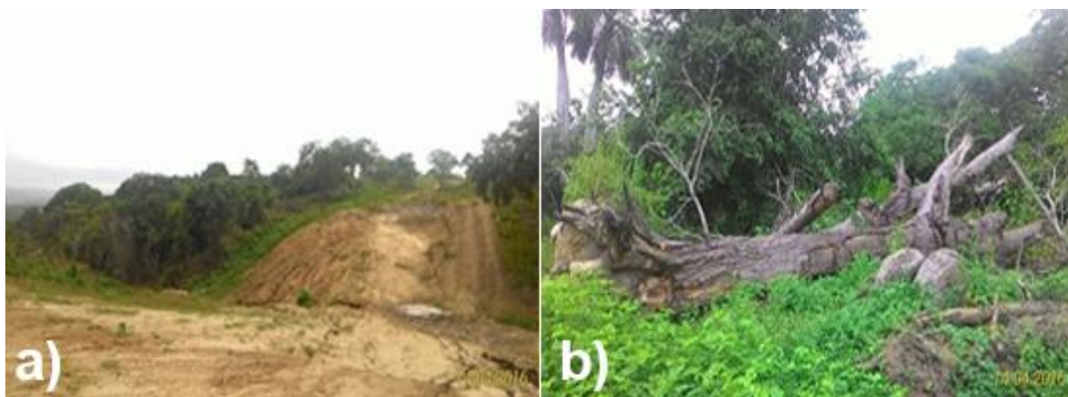
Figura 7 - a) Trecho de abertura para construção de estrada da Alça Leste, situado ao lado do fragmento BTA 1 (Mata dos Aranhas); b) Árvore da espécie Schinopsis brasiliensis Engl., derrubada por máquina pesada. Fonte: Registro de campo, por Alessandro S. Souza.
