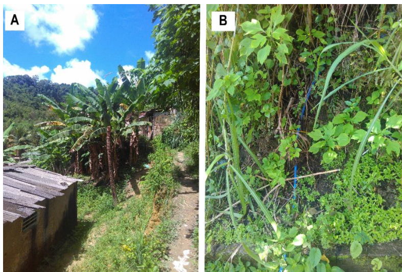
Figura 10 – Corte de parte da encosta (A) e ligações clandestinas da rede de abastecimento (B). Fonte: Autores (2018).
