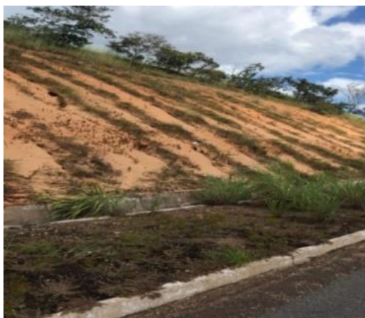
Figura 5 - Erosão laminar em talude no ponto P10 as margens da rodovia TO-445. Fonte: autor (2019).
