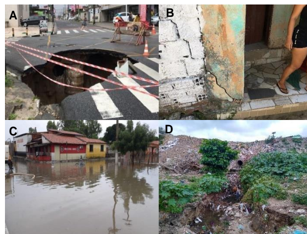
Figura 4 - a) cavidade gerada por processo remoção mecânica de sedimentos decorrente da injeção de fluxo subterrâneo devido o estouro de galeria pluvial após atuação de sistema de climático que provocou chuvas intensas na área no ano de 2017; b) rachadura observada em paredes de residência edificada dentro de uma depressão cárstica localizada no bairro João Paulo II; c) registro de evento de enchente ocorrida em depressão cárstica no bairro Jardim Veneza. Fonte: Informa Paraíba (2019); d) disposição de efluentes para o interior de uma depressão carstica localizada no bairro Cidade dos Funcionários I.
