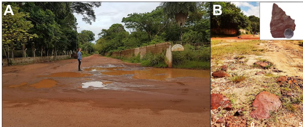
Figura 2 – (A): Localização do alagamento permanente da Rua Vera Paz em frente a guarita de acesso ao Campus Tapajós da UFOPA; (B): Afloramento de concreção ferruginosa ao longo do alinhamento geofísico com detalhe para amostra de Laterita.
