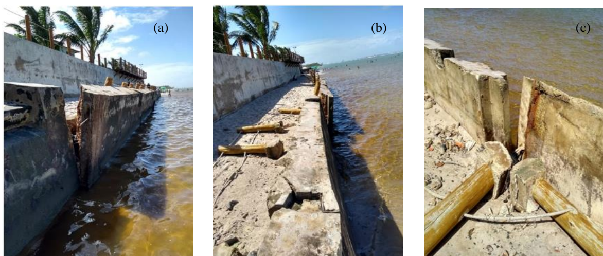
Figura 4 – (a,b,c) situação do muro de contenção marítima existente, Ipojuca/PE.
