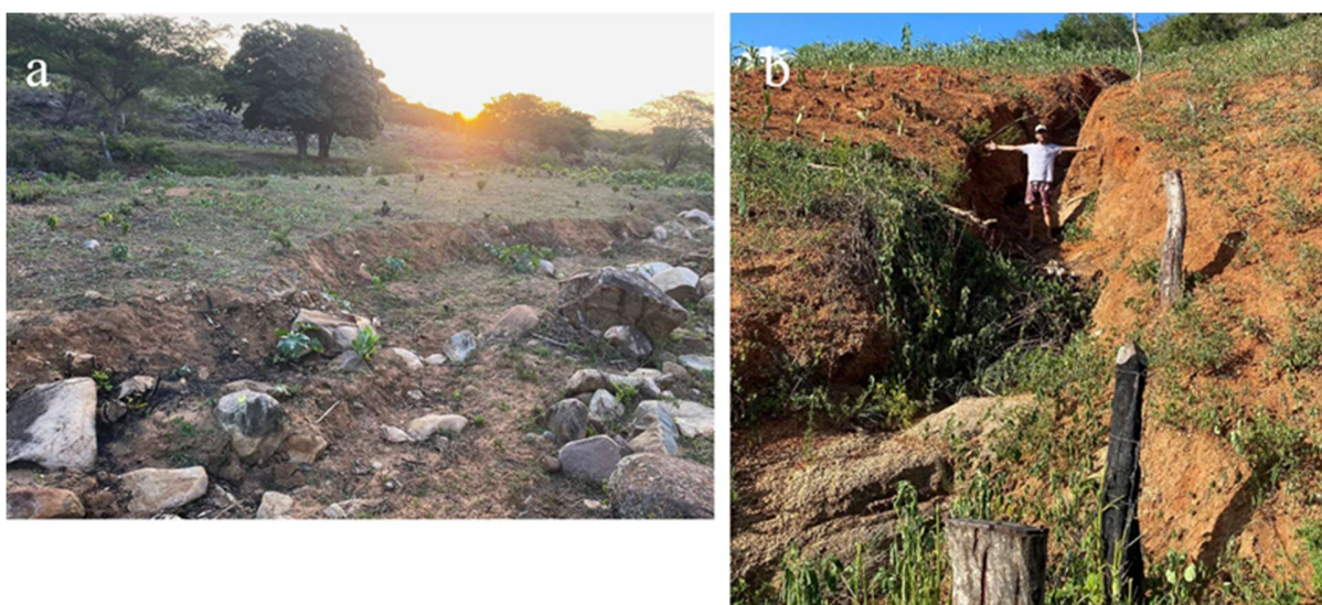
Figura 11 - Erosão muito forte em: a) cultura de milho e palma em encosta; b) pastagem. Poço das Trincheiras - AL. Fonte: Autores (2023)
