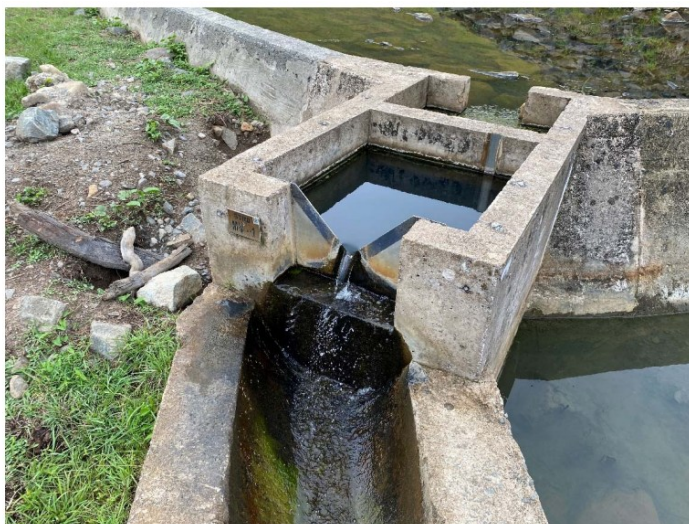
Figura 9 – Medidor de Vazão Triangular. Fonte: Intertechne (2022).
