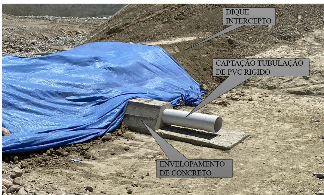
Figura 18 – Tubulação na Região de Captação.
