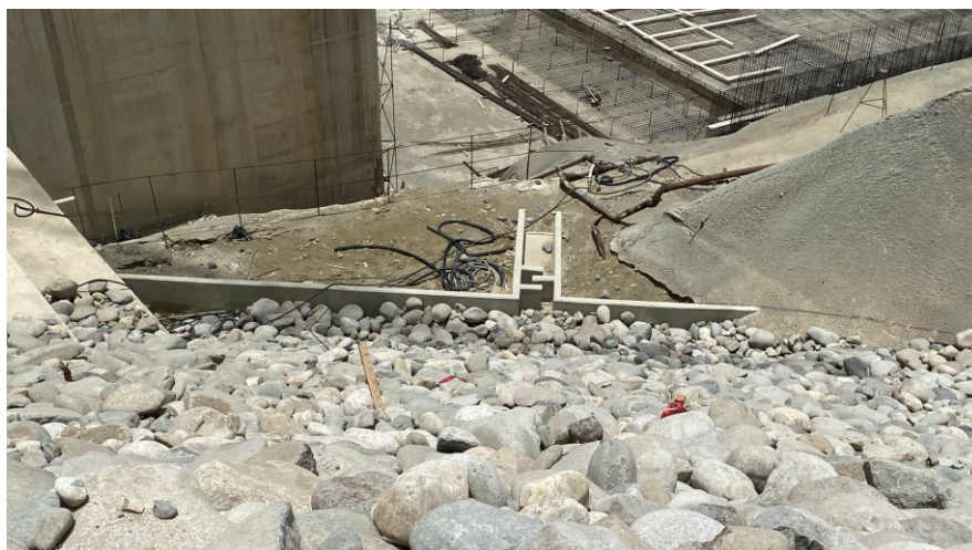
Figura 6 – Medidor de Vazão com Mureta Externa (Implantação). Fonte: Barreto (2023).
