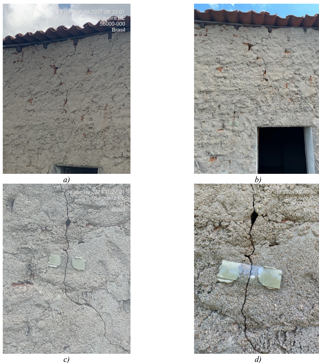
Figura 8 – Fissuras no revestimento da fachada da 2ª casa. a) 19/03/2024. b) 25/03/2024. c) 02/04/2024. d) 08/04/2024.
