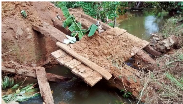
Figura 9 – Ponte destruída pela água do Riacho. Fonte: Trabalho de campo (2015).
