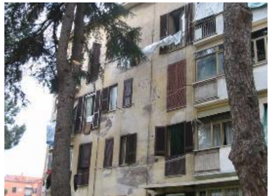
Figura 10: Fachada degradada antes da reabilitação.
