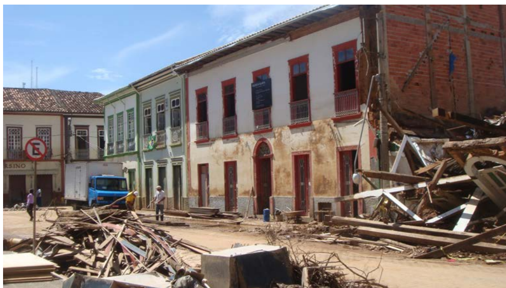
Figura 1 - Vista de parte do casario da Praça Oswaldo Cruz logo após a enchente de janeiro de 2010 mostrando um edifício de taipa de pilão e de mão inteiramente arruinado.
