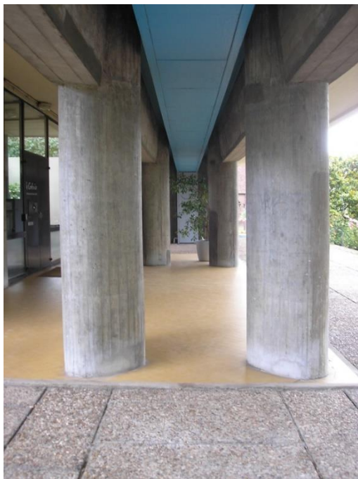
Figura 5: Pilares e vigas de concreto aparente do pavimento térreo do bloco dos dormitórios do Pavilhão Suíço da Cidade Universitária de Paris, 1929-1933.
