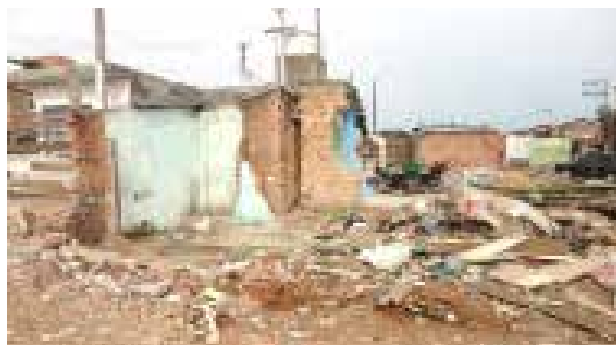
Figura 5: Casas demolidas na Avenida Tronco, Porto Alegre.
