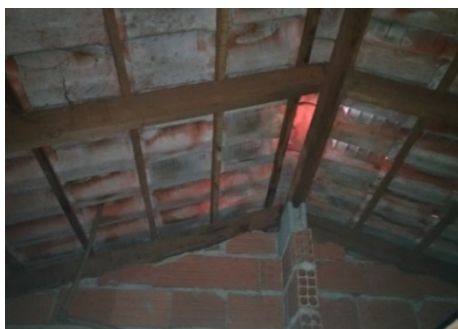
Figura 12: Frestas entre parede geminada e telhado.
