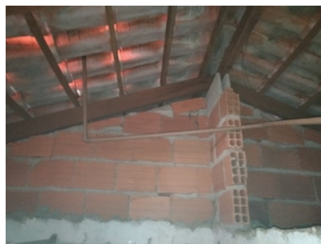
Figura 13: Frestas entre parede geminada e telhado.
