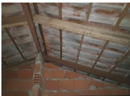
Figura 14: Frestas entre parede geminada e telhado.
