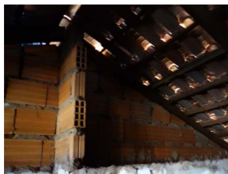
Figura 15: Frestas entre parede geminada e telhado.
