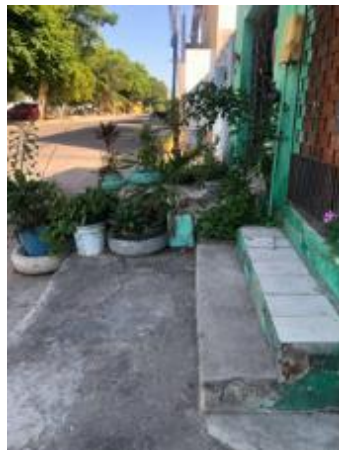
Figura 7 – Calçada na Avenida C com desníveis e obstáculos (Conjunto Esperança).
