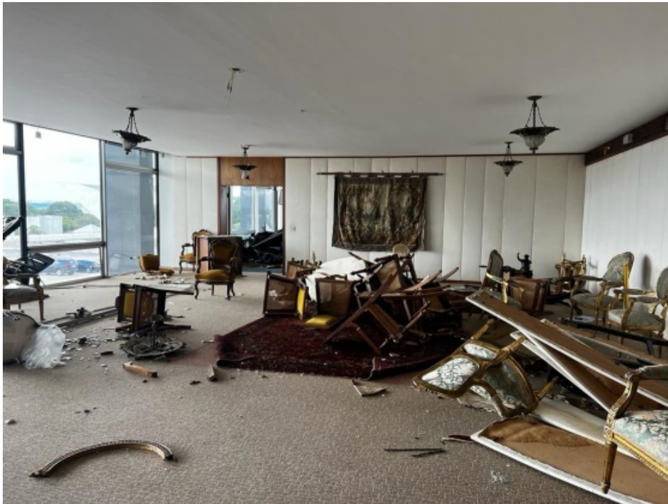
Figuras 5 a 8: Inventário dos danos causados aos palácios e às suas obras de arte após atentados de 08 de janeiro de 2023.
