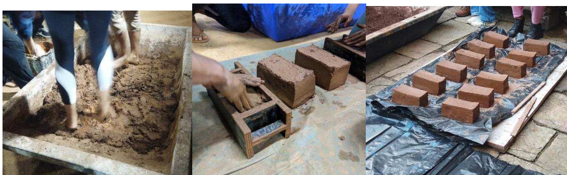
Figura 2: Prática do adobe, respectivamente: amassamento do solo na Oficina 2 (esq.), moldagem na Oficina 1 (centro), e dos adobes prontos na Oficina 3 (dir.), 2023.
