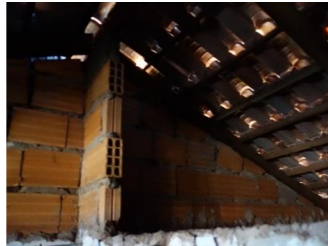
Figura 15: Frestas entre parede geminada e telhado.
