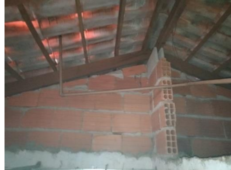
Figura 13: Frestas entre parede geminada e telhado.
