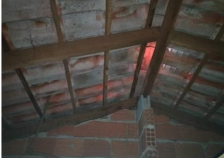
Figura 12: Frestas entre parede geminada e telhado.
