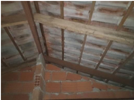
Figura 14: Frestas entre parede geminada e telhado.
