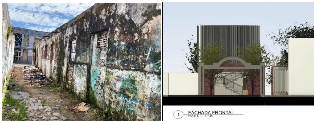
Figura 5: Fachada para a Rua Chile com Beco da Quarentena (antes e depois da intervenção)
