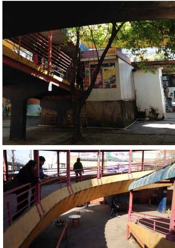
Figura 15. Exemplos de espaço com potência de acolhimento: espaços residuais entre as estruturas de passagens da estação.
