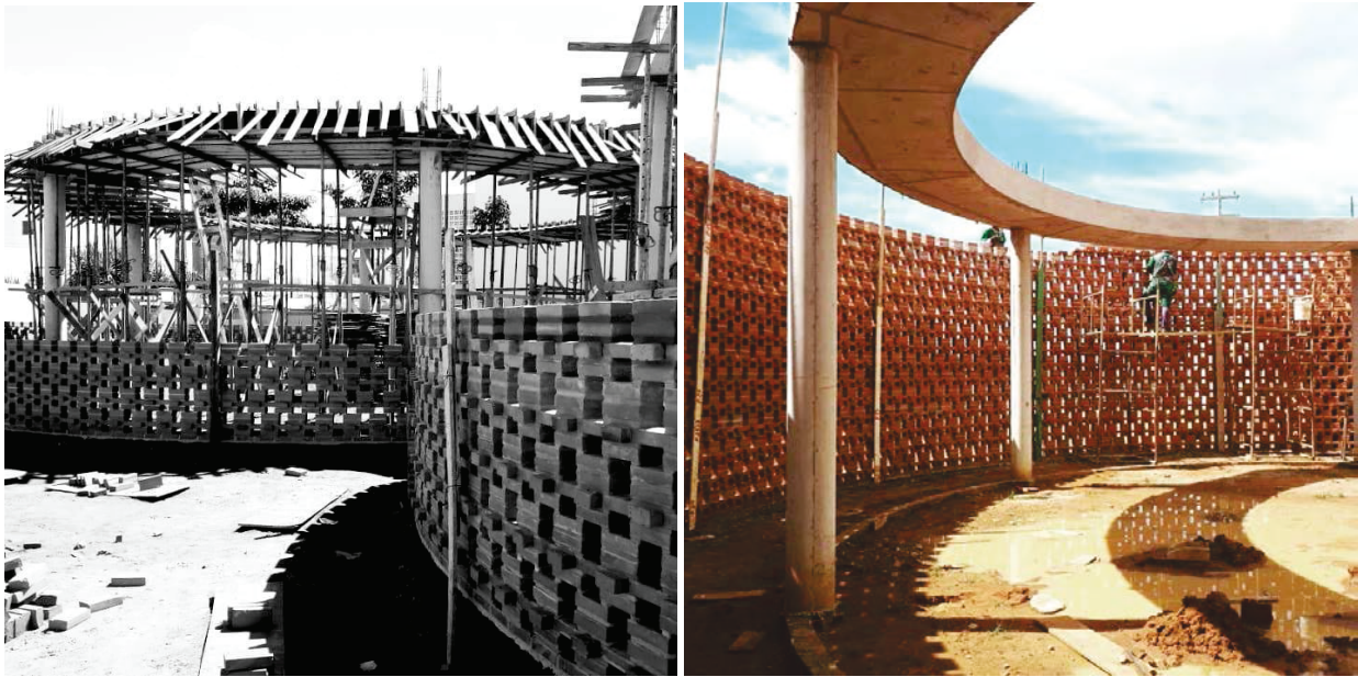
Figura 13: Academia-escola Unileão ainda em obra em que é possível observar a pele externa de tijolos sendo erguida simultaneamente à estrutura de concreto.
