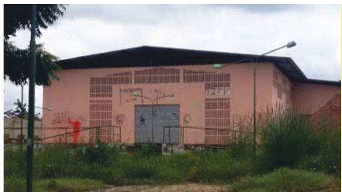
Figura 19: Depredação do Mercado Público
