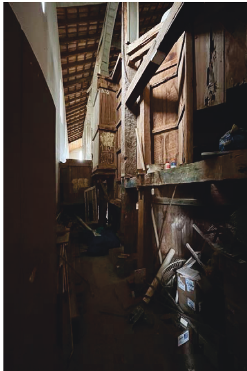
Figura 9: Estado de conservação da parte posterior do retábulo lateral direito.
