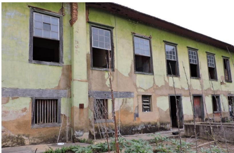
Figura 6: Detalhamento das intervenções com argamassa cimentícia sobre a taipa de mão na fachada Nordeste.
