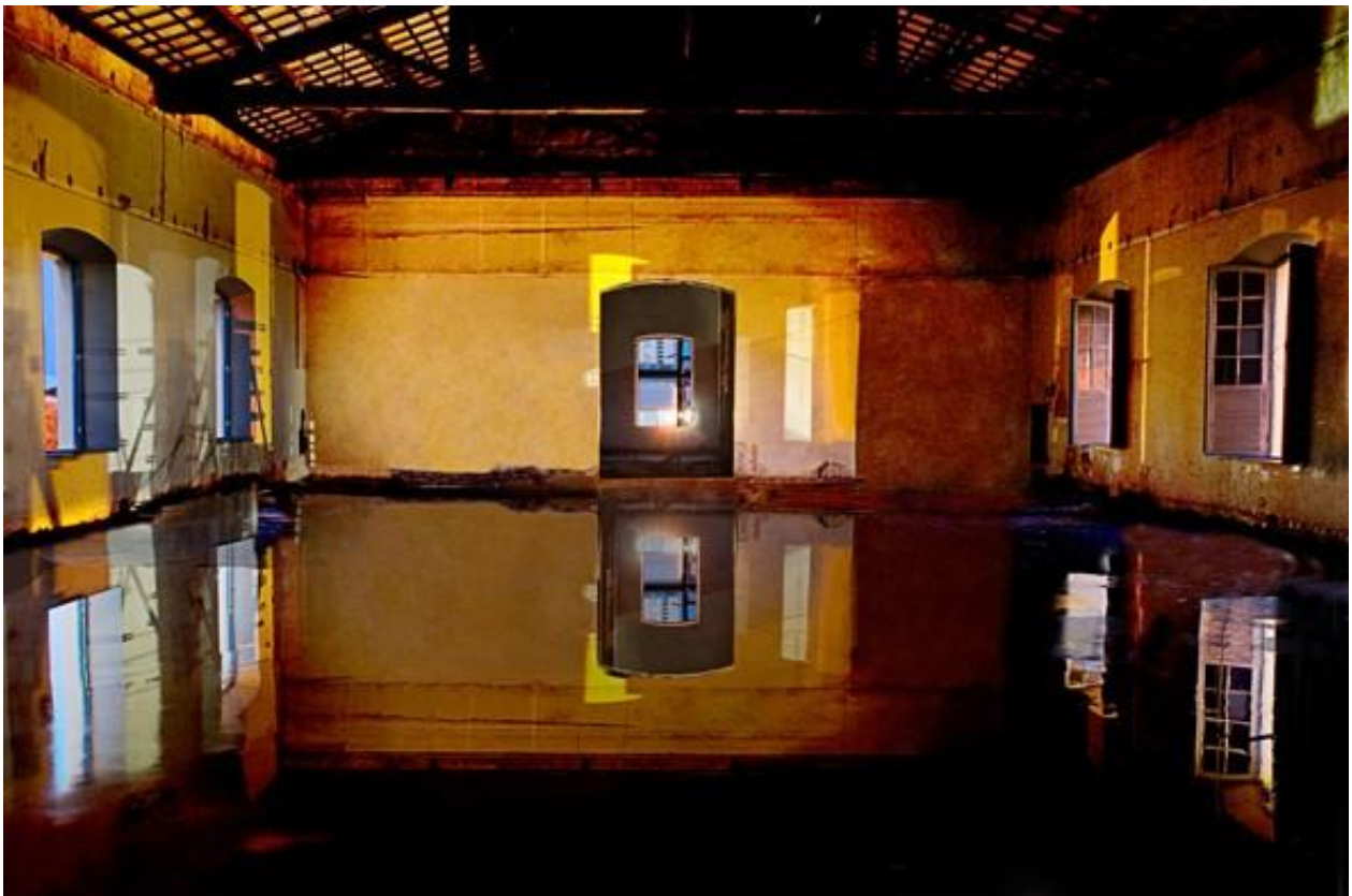
Figura 5: Estado de conservação do edifício da Antiga Alfândega de Fortaleza anterior ao processo de intervenção.
