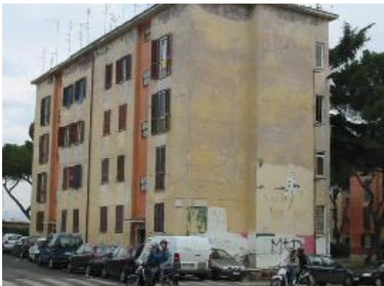
Figura 9: Fachada degradada antes da reabilitação.
