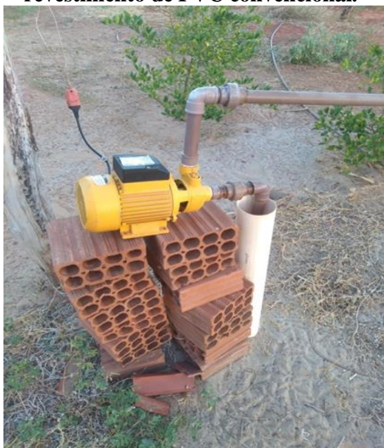
Figura 4: Poço tubular com revestimento de PVC convencional.
