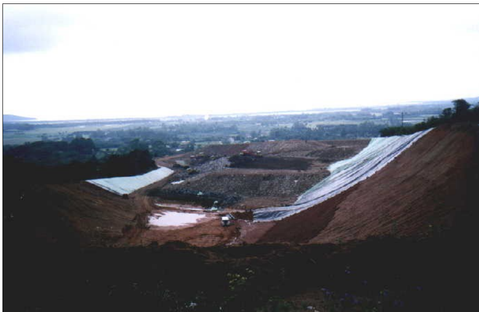
Figura 05: Aterro Sanitário da Extrema
