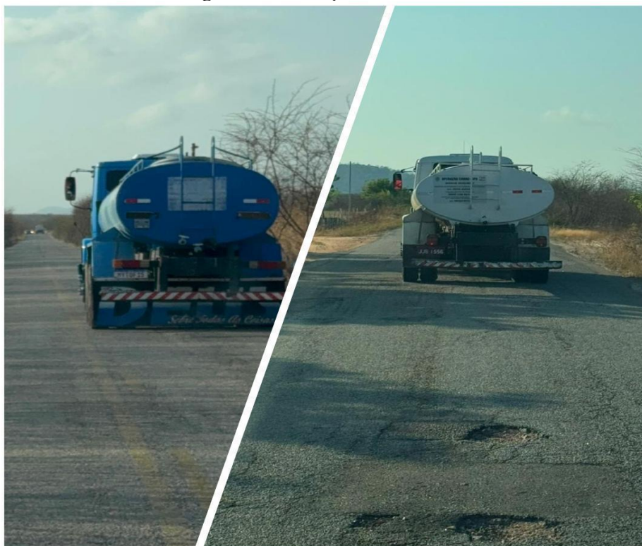
Figura 2 – Condições das estradas
